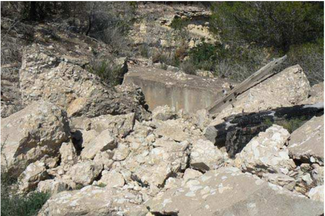
NIU DE METRALLADORA DESTRUIT, PROP DE LA CARRETERA (2007).
